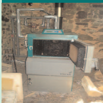
25kW Vigas boiler
